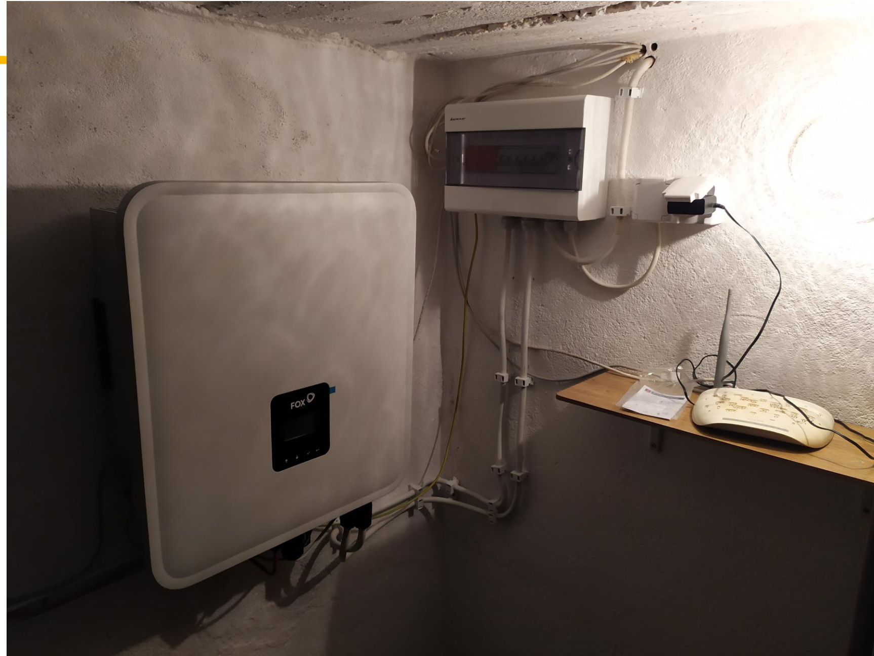
Ładowarka magazynu energii o mocy znamionowej 5 kW
