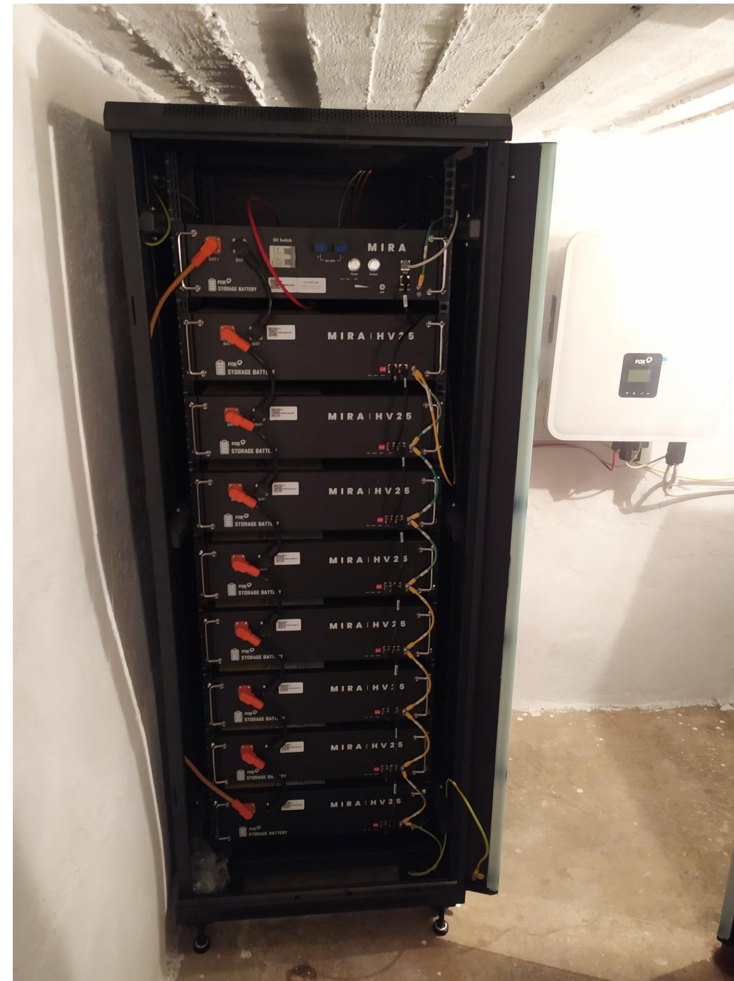
Magazyn energii o pojemności 19,66 kWh
