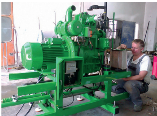
Rys. 6. Układ kogeneracyjny o mocy 10 kW (silnik Perkinsa i prądnica Celma Cieszyn)
