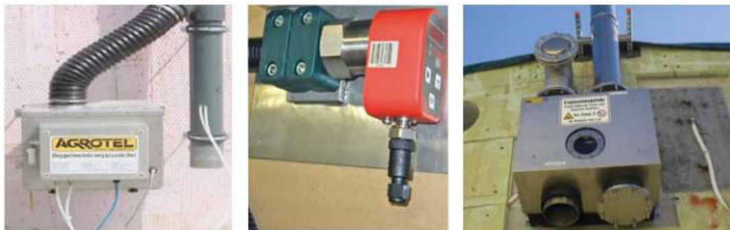
Rys. 8. Dmuchawa z regulatorem ciśnienia, gazomierz oraz zabezpieczenie ciśnieniowe zainstalowane za magazynach biogazu [1]
