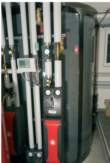
12. Umieszczony w piwnicy warstwowy zasobnik ciepła o pojemności 4000 l w domu jednorodzinnym o powierzchni 170m 2 , pozwala na zaspokojenie w 85% całorocznego zapotrzebowania na ciepło i c.w.u. z promieniowania słonecznego
