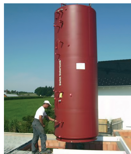
7. Duży zasobnik ciepła montowany w tzw. domu słonecznym. Źródło: www.aktives-sonnenhaus.de
