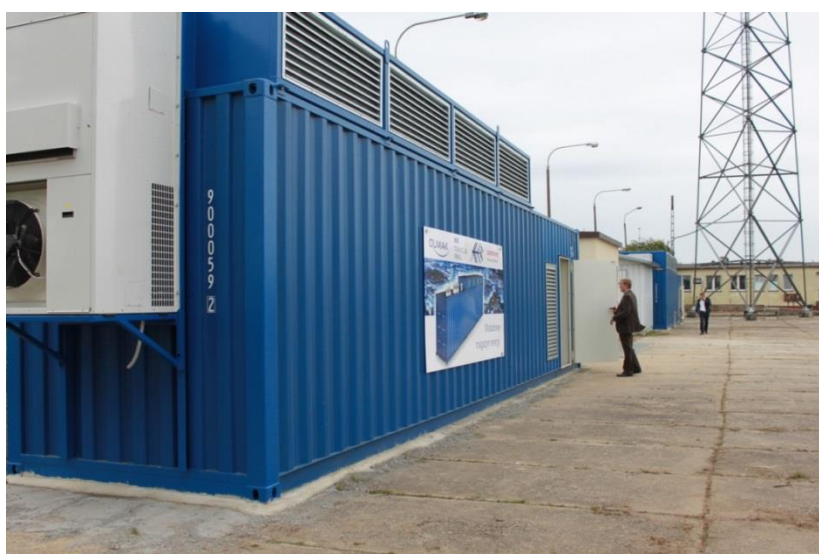
Rys. 22. Pierwszy w Polsce modułowy magazyn energii elektrycznej o mocy 0,75 MW i pojemności energii 1,5 MWh
